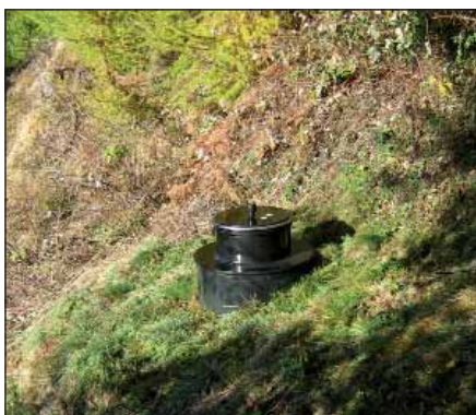
Innen- und Außenansicht der Weibhofer-Quellfassung
