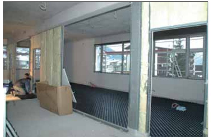
Das neue Marktgemeindeamt ist im Niedrigenergiestandard ausgeführt, verfügt über eine kontrollierte Wohnraumlüftung und wird mittels einer Niedertemperatur-Fußbodenheizung beheizt werden.
