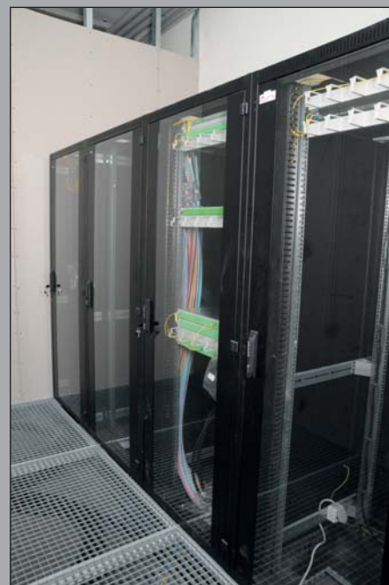
Verteilerzentrale im Mehrzweckhaus Nußdorf
