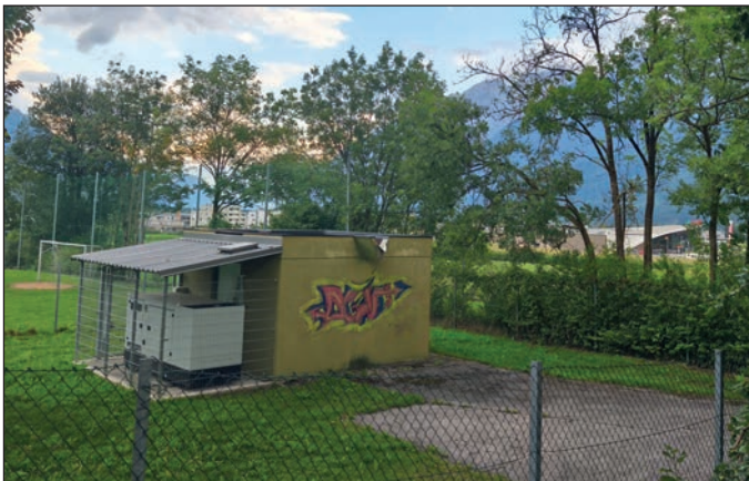
Die Rückversicherung für unsere Trinkwasserversorgung bildet der Tiefbrunnen am Spiel- und Tummelplatz Mitterweg.
