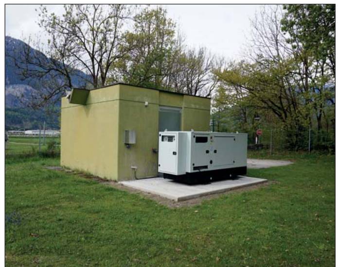
Großes Notstromaggregat beim Debanter Tiefbrunnen
